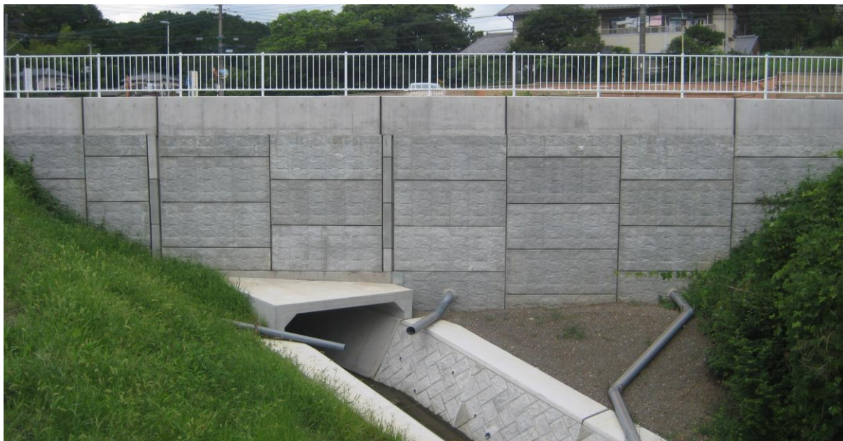
埼玉県飯能市内での補強土壁盛土材の施工事例／スーパーテールアルメGS工法／2015/06
